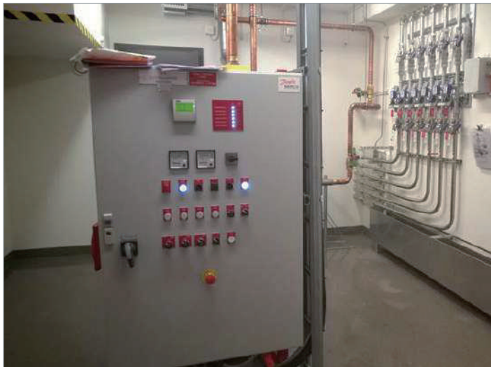
隆德大學安裝的緊湊型 SEM-SAFE® 高壓細水霧裝置。
